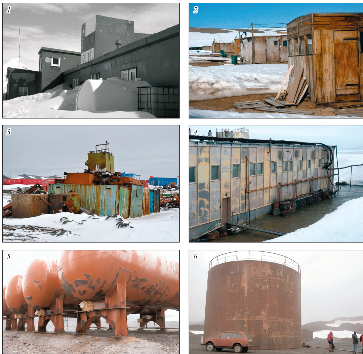
Рис. 4. Примеры разрушения окрашенных поверхностей зданий и корродированных топливных емкостей по данным инспекций по Договору об Антарктике [11].
