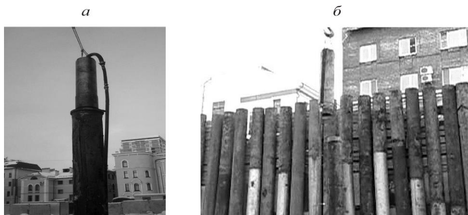
Рис. 4. Пневмомолот Т-500 на строительстве метрополитена в Казани: а — забивание одиночной сваи диаметром 530 мм; б — сооружение подпорной стены из труб диаметром 426 мм
