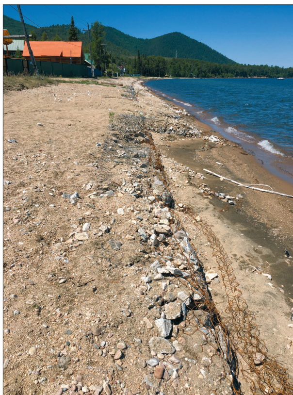
Рис. 2. Состояние инженерного сооружения защиты берега габионного типа в с. Максимиха, июнь 2022 г. Фото А. Плюснина.
